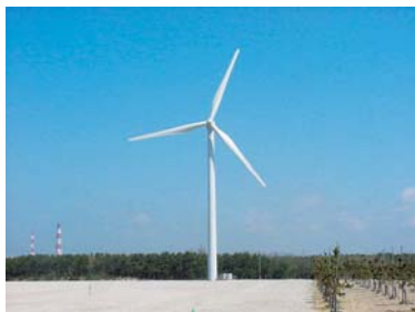
秋田油槽所内の風力発電設備
